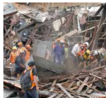
Bergungsarbeiten nach dem Erdbeben
